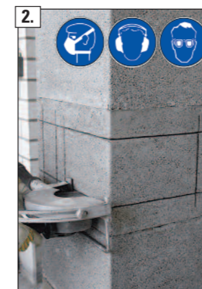
2. Öffnungsschnitt mit Winkelschleifer herstellen. ACHTUNG! Beachten Sie unbedingt die Hinweise zum Arbeitsschutz auf der Rückseite!
