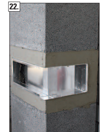
22. Überschneite am Mantelstein müssen wieder mit Mörtel verschlossen werden.
